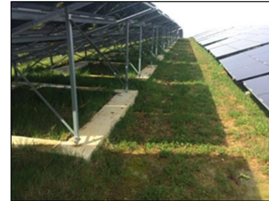
Reprise végétale sous les panneaux photovoltaïques Source : ARTIFEX
